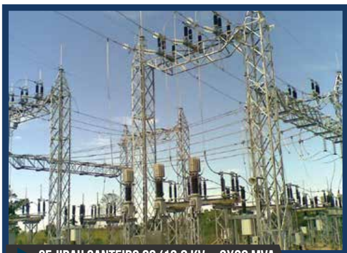
▶ SE JIRAU CANTEIRO 69/13,8 KV – 2X20 MVA
