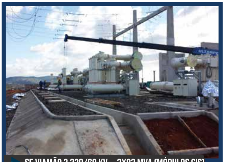
▶ SE VIAMÃO 3 230/69 KV – 3X83 MVA (MÓDULOS GIS)
