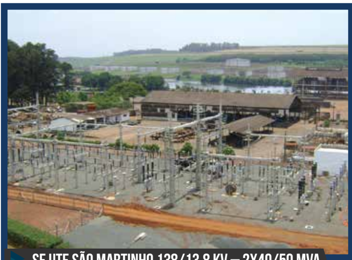
▶ SE UTE SÃO MARTINHO 138/13,8 KV – 2X40/50 MVA
