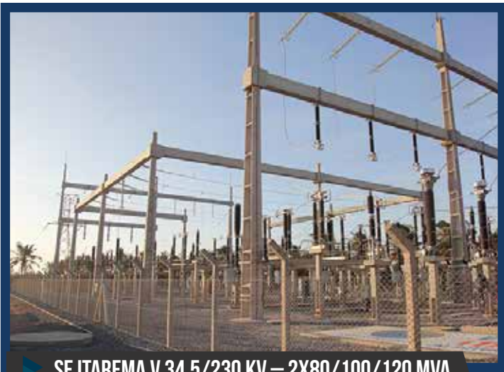
▶ SE ITAREMA V 34,5/230 KV – 2X80/100/120 MVA
